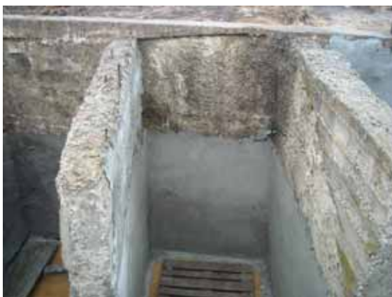
Капитальный ремонт гидротехнических сооружений в районе населенного пункта Ретяжи Дмитровского района Фото из архива сайта orel-region.ru
