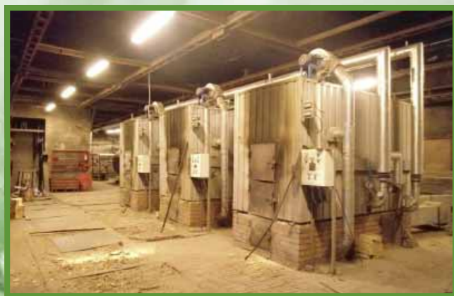
Котельная п. Хелюля
