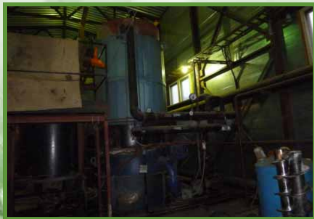
Котельная п. Ляскеля
