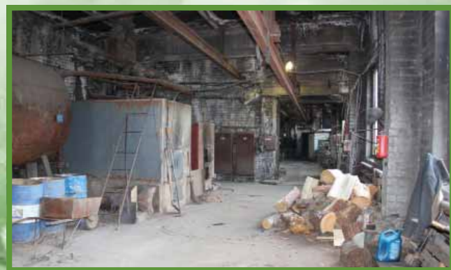
Котельная п. Пуйккола
